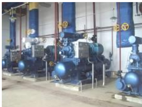
制冷压缩机 エアコンプレッサー
